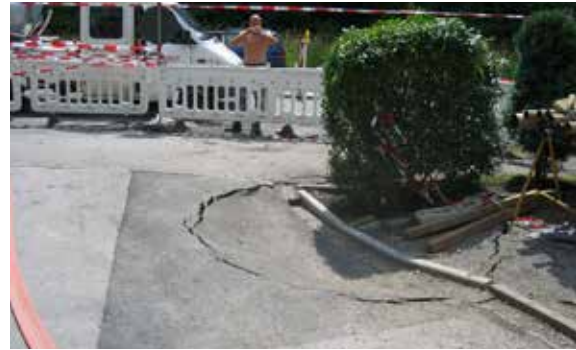
Abb. 4: Dellen und Rissbildung am Schacht A
